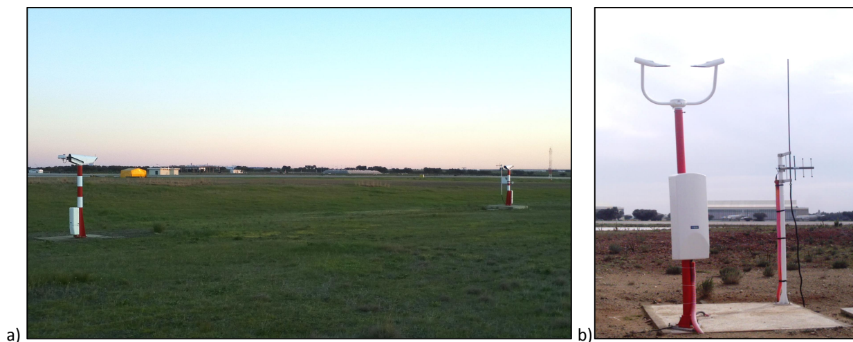
Figura 3.1 - Instrumentos da Base Aérea de Beja; a) transmissómetro, b) difusómetro.
