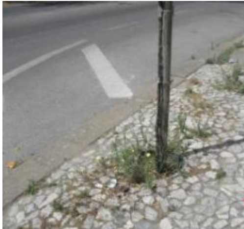
Figura 62 - Dimensão da caldeira desadequada no Bairro das Nogueiras Fonte: Própria
