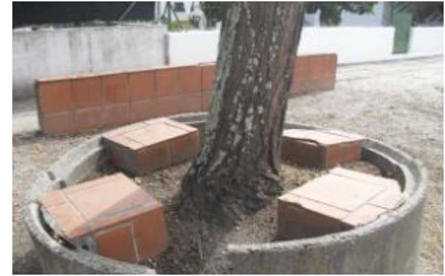
Figura 41 - Impermeabilização e compactação do solo, para além de esteticamente incorreta. Rua Augusto de Melo – Bairro da Casinha Fonte: Própria
