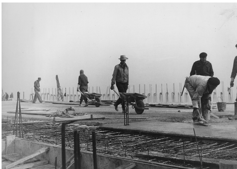
[Fig. 68] Construção da última laje da Unidade de Habitação de Marselha (FLC L1-13-235)
