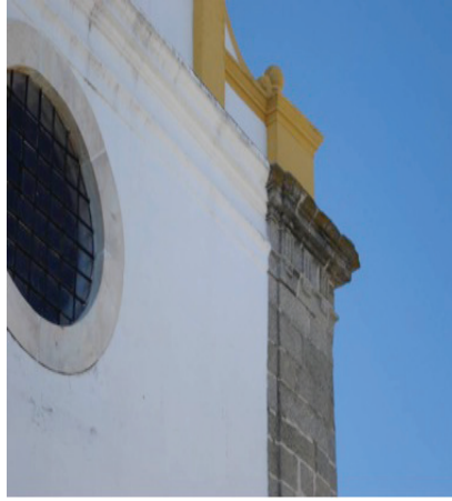
Fig.7. Igreja do Convento do Senhor Salvador do Mundo. Évora (1610). Fachada axial. Detalhe de óculo, friso contínuo liso e cornija de múltiplo ressalto e cunhal com elementos decorativos de tipologia dórica
