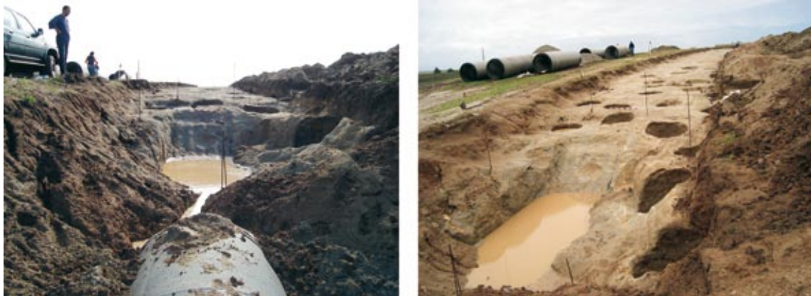
Fig. 3 Estruturas negativas fortemente afectadas pela escavação da vala para inserção da tubagem na extremidade NW do corredor, na área objecto da intervenção arqueológica.
