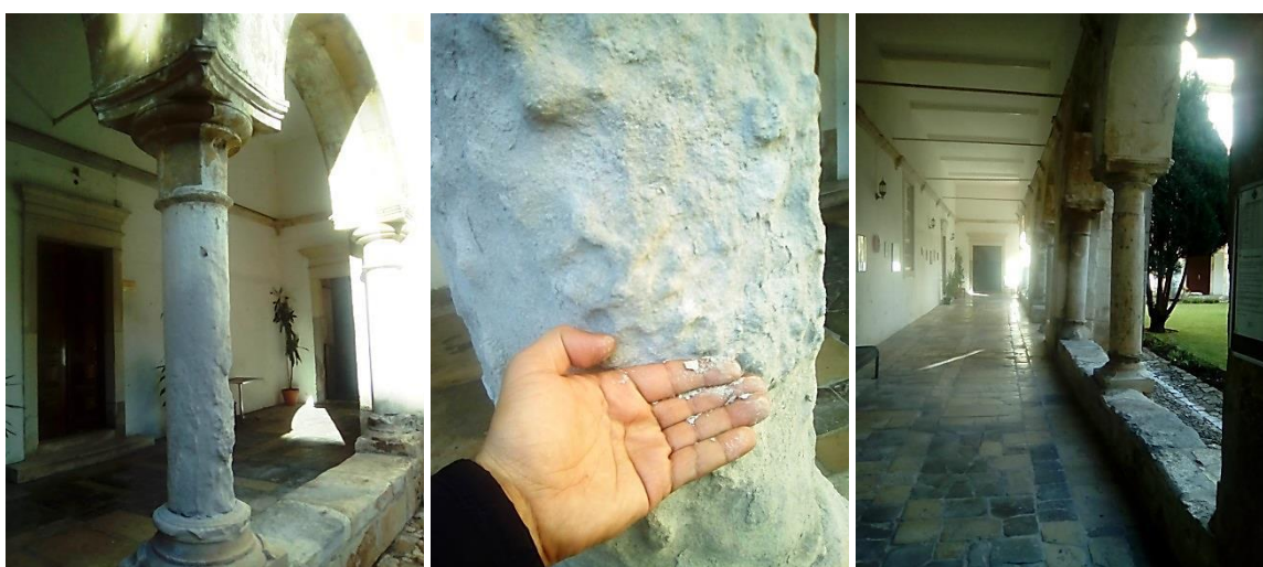
Fig. 109- Coluna em calcário fino, brando, creoso e oolítico (observa-se perda de material por erosão). Fig. 110- Pormenor da perda material. Fig. 111- Galeria do Claustro do Colégio da Graça. (após a queda das abóbodas foram colocados tirantes que estabilizam as arcarias). Claustro do Colégio da Graça. Fotos do autor, 2019.
