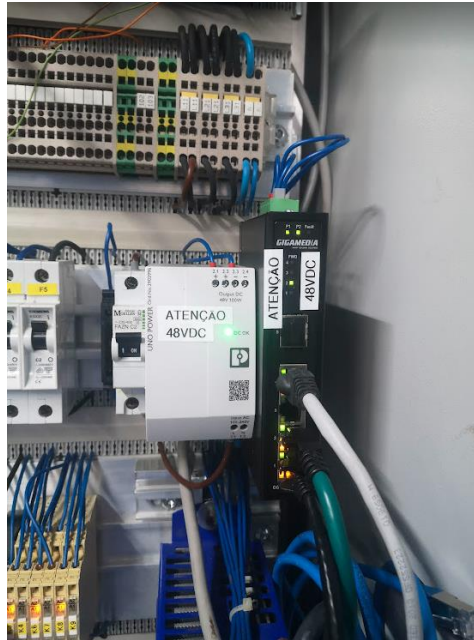
Figura 23 – Instalação da fonte de tensão e distribuidor de ethernet
