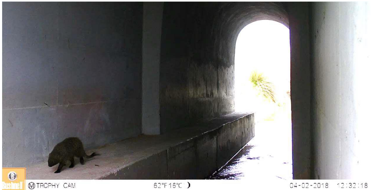
Figura 11- Fotografia demonstrativa de uma Passagem Hidráulica com passadiços (fonte: Garcia, 2021)
