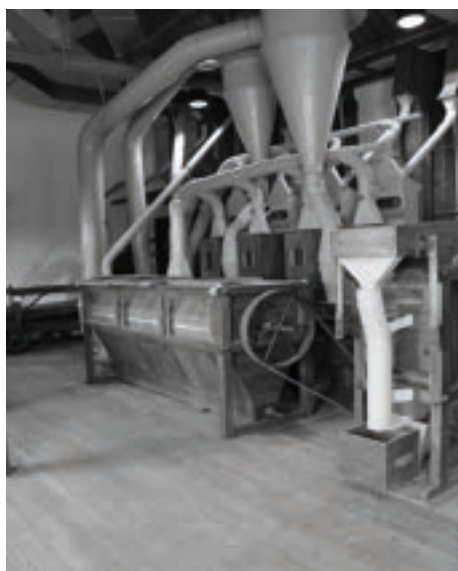
264. Espaço e maquinaria da secção de limpeza de arroz.
