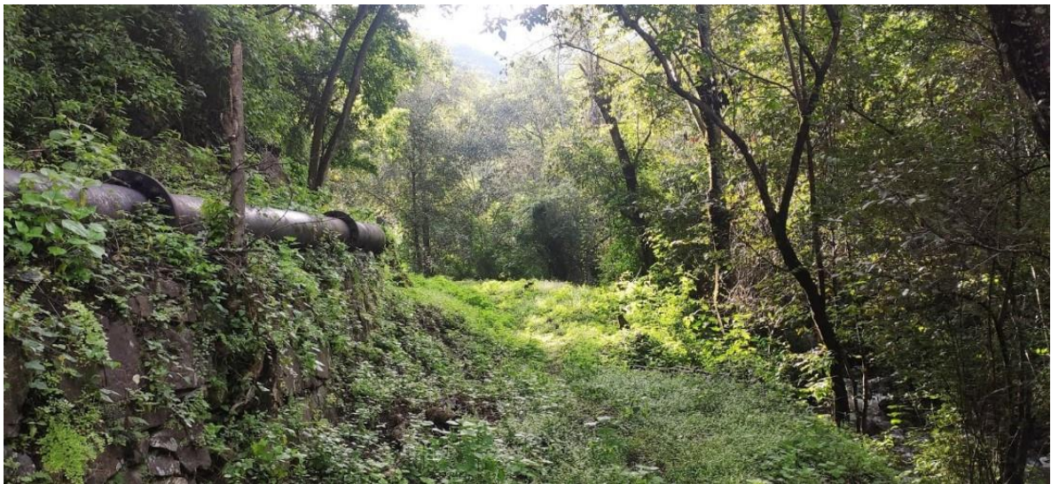
Figure 71. Canalisation d'eau pour l'ancienne hydroélectrique de La Luz . Source: Photographie Arturo Salinas
