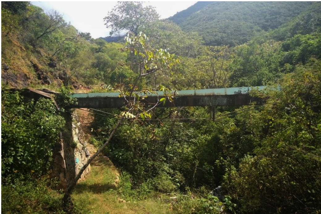
Figure 92. Section de la canalisation d'eau. Source: Photographie Arturo Salinas.
