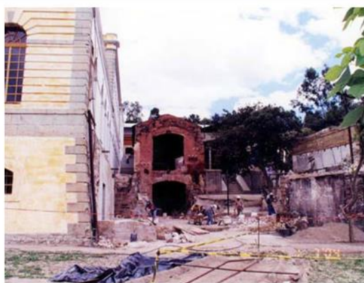
Maison de Puissance
