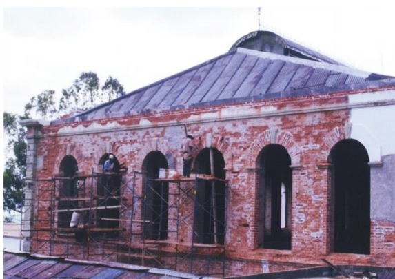
Figure 56. Façade Est, Usine La Soledad avant sa rénovation. Source: Photographie Architecte Claudina López.
