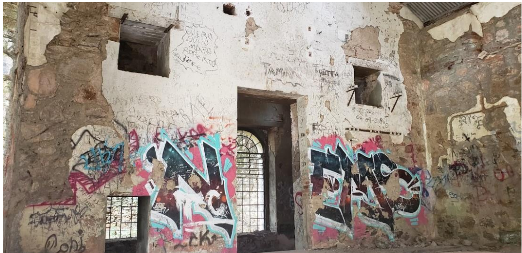
Figure 95. Intérieur de l'hydroélectrique. Source : Photographies Arturo Salinas.
