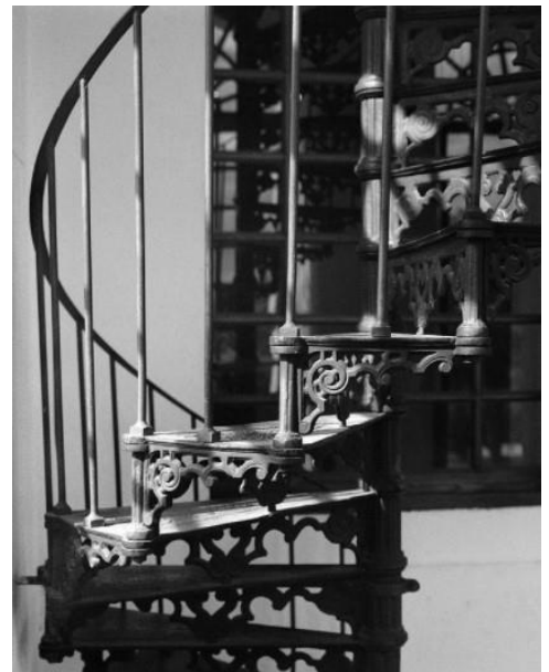
Figure 62. Détail de l'escalier métallique en usine La Soledad . Source: Photographie Fausto Nahúm.
