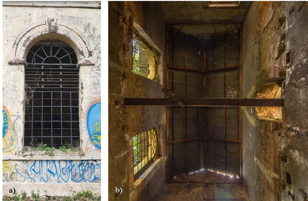
Figure 96. a) Détail de la fenêtre ; b) Intérieur du toit à pignon. Source : Photographies Arturo Salinas.
