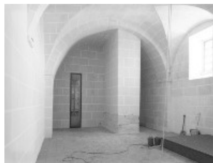
Fig.106. Sala Nobre, fotografia anterior à obra de restauro, é possível ver o reforço estrutural da torre sineira. © Prémio Nuno Teotónio Pereira 2016.
