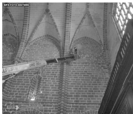
Fig.89. Instalação de sistema de monitorização pelo LNEC em 2004. © SIPA, IPA.00002724, FOTO.00675099.
