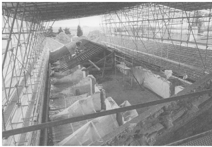
Fig.104. Desmonte da cobertura existente na antiga ala das celas - sob a proteção das lonas estão os vestígios das antigas paredes com pinturas sobre estuque. © Manuel Ribeiro
