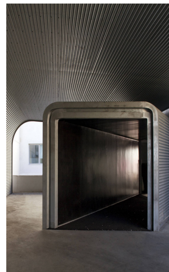
Fig. 156 - Manga metálica de conexión entre edificios.
