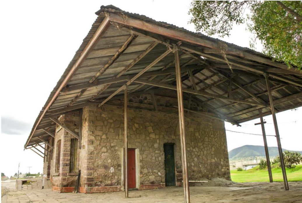
Figure 43 – La structure d’un hangar. Il est possible de remarquer que la structure de l’hangar est faite avec du bois, couverte avec des tôles en zinc, et soutenue par des poutrelles en fer. Il s’agit de la gare d’Iturbe, du Ferrocarril Interoceánico .
