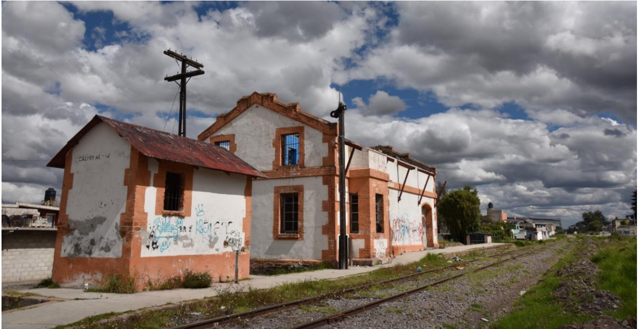
Vue du côté gauche de la façade de la gare et du quai.
