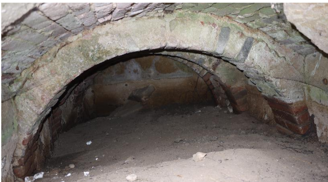
FIG. 61| Moinho da Ponte de Évora - Assoreamento do cabouco e sétia ao fundo. Fonte: Fotografia do autor, 2017
