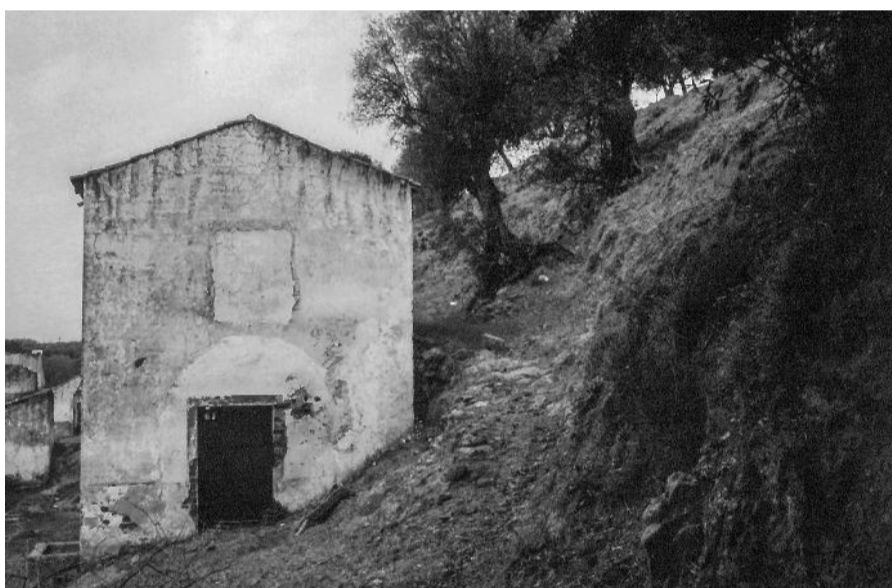
FIG. 17| Moinho Novo, margem norte do Rio. Fenómeno geomorfológico de dinâmica de vertentes. Fonte: Gabinete Técnico Local- GTL de Montemor-o-Novo em 2000
