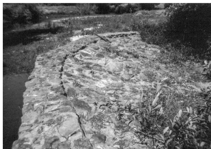
FIG. 65 | Açude da Rata- Adução do moinho da Ponte de Évora – Vista do exterior do açude, lado jusante do dique, muro em jorramento do dique. Fonte: Gabinete Técnico Local- GTL de Montemor-o-Novo em 2000
