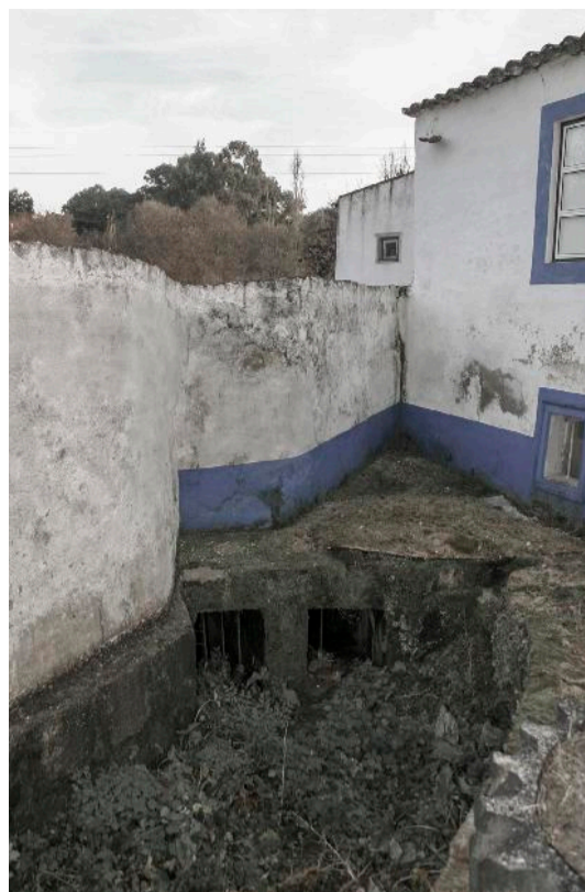
FIG. 58| Moinho da Ponte de Évora - Caldeira, boca dos cubos. Fonte: Fotografia de Paulo Canas, 2007
