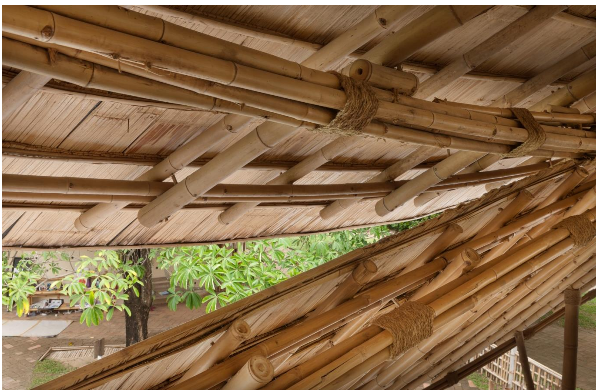
Figura 123 Dilataciones en la cobertura de Bamboo Sports Hall
