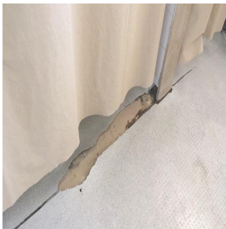
Figura 13 - Exemplo de um chão deteriorado e potenciador de risco de queda
