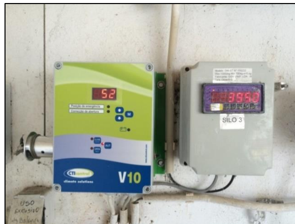
Figura 14 - Dispositivo de abertura automática de janelas e dispositivo de ração nos silos (Fotografia original).
