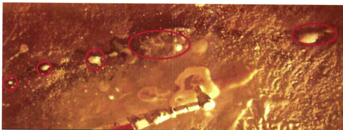
Figura 4.58 – Aparecimento da espuma ao longo da fissura
