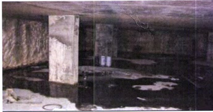
Figura 4.55 – Aspecto do pavimento do parque de estacionamento subterrâneo.
