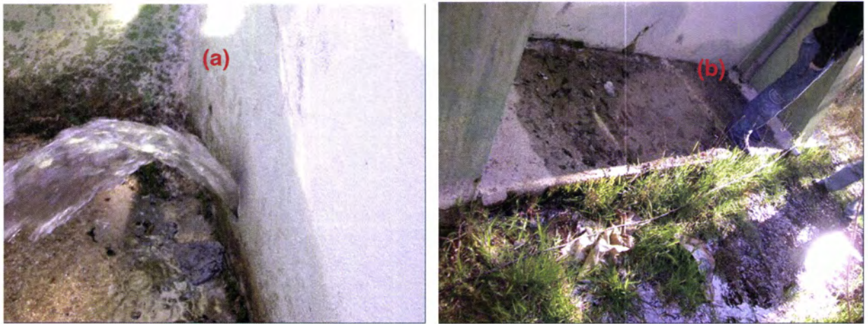
Figura 4.60 (a), (b) – Problemas a resolver no reservatório de água
