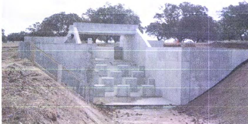
Figura 3.4 – Macro rugosidades associadas ao canal de descarga de cheias (Vista de Jusante)
