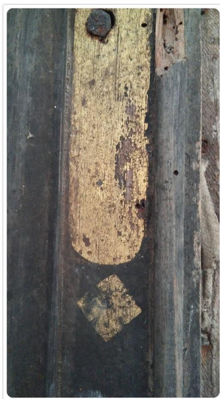
Figura 125 - Danos e Patologias: Destacamento da camada cromática, ataque de insetos xilófagos. Autor da fotografia: Débora Fortunato.
