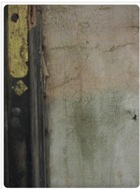
Figura 129 – Danos e Patologias: Tela mal-acondicionada na grade. Autor da fotografia: Débora Fortunato.
