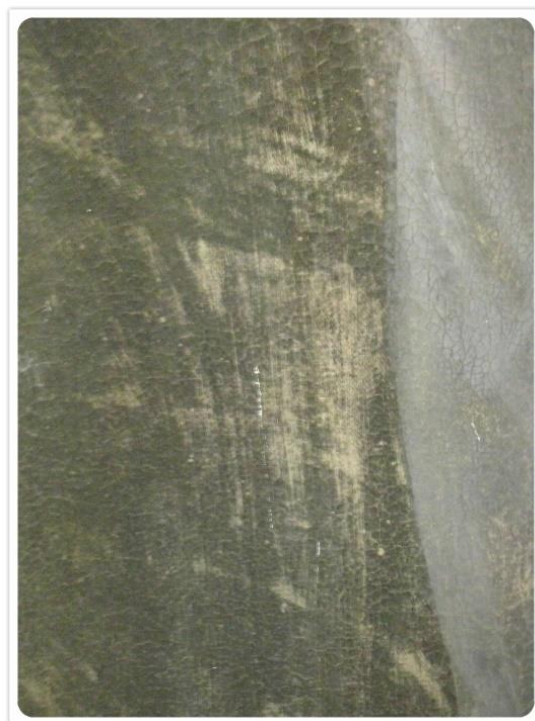
Figura 128 – Danos e Patologias: Abrasão. Autor da fotografia: Débora Fortunato.
