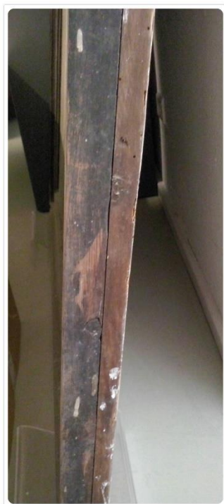
Figura 131 – Danos e Patologias: Abrasão, vestígios de tinta, orifícios causados pelos insetos xilófagos. Autor da fotografia: Débora Fortunato.
