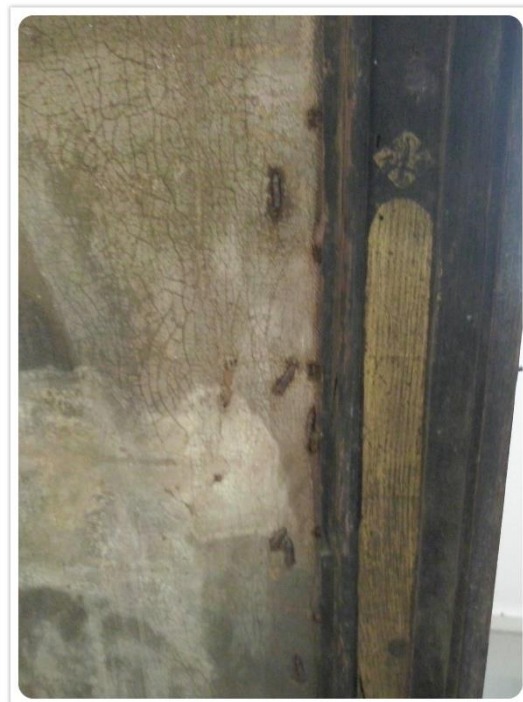
Figura 117 – Danos e Patologias: Oxidação de elementos metálicos. Autor da fotografia: Débora Fortunato.
