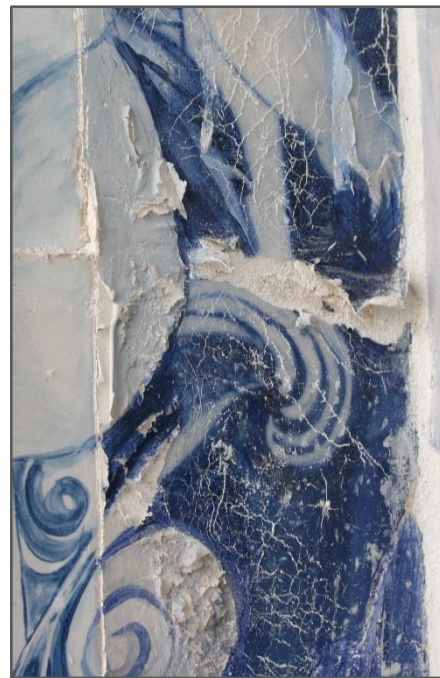
Figura 92. Presença de sais solúveis sobre os vidrados e pastas de preenchimento, provocando a sua desagregação e pulverulência e destacamento da camada de reintegração cromática da pasta de preenchimento. Capelas dos Passos de Elvas, 2013.
