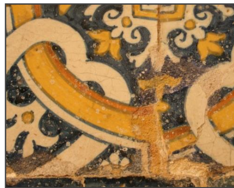
Figura 58. Materiais de preenchimento com a superfície rugosa e escurecimento das reintegrações cromáticas. Painel de S. Sebastião, Nossa Senhora e Santo António, Igreja e Convento de Santa Marta/ Hospital de Santa Marta, 2012.
