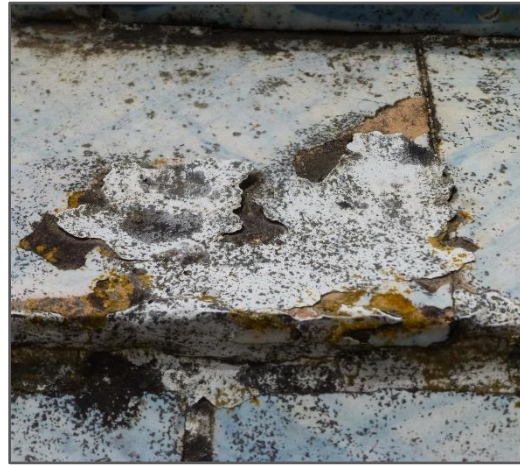
Figura 75. Contaminação biológica dos preenchimentos de lacunas. Canal de Queluz, 2012.
