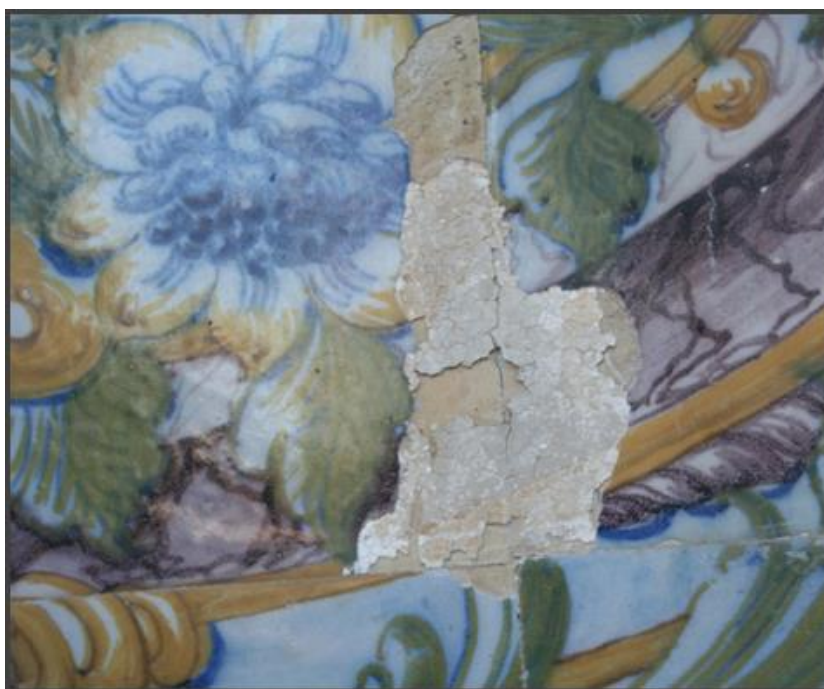
Figura 68. Pormenor de um preenchimento que apresenta várias fissuras e encontra-se em destacamento, sendo visíveis alguns vestígios de reintegração cromática. Quinta dos Azulejos, 2012.
