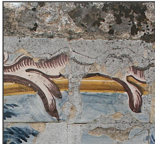
Figura 77. Material de preenchimento colonizado por infecção biológica. Palácio Marquês de Pombal, 2012.
