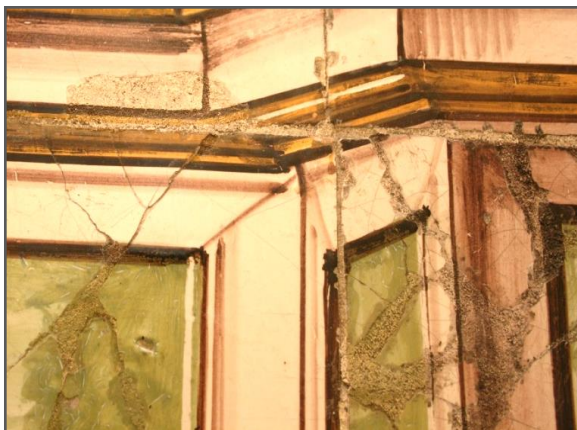
Figura 57. Materiais de preenchimento não nivelados conferem uma superfície rugosa. Algumas reintegrações encontram-se sobre o original e verifica-se o escurecimento generalizado das mesmas. Painel de S. Sebastião, Nossa Senhora e Santo António, Igreja e Convento de Santa Marta/ Hospital de Santa Marta, 2012.
