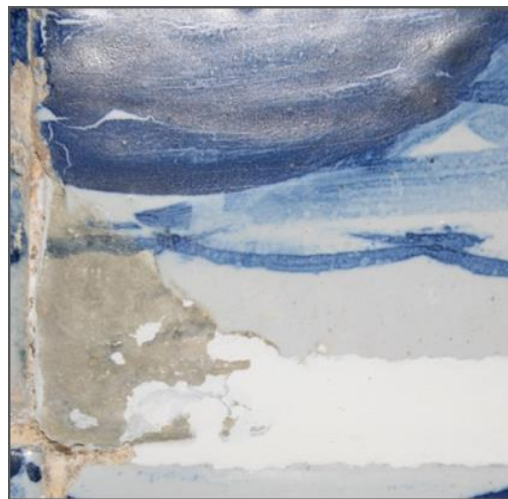
Figura 61. Alteração cromática e destacamento quase total da reintegração cromática. Parede lateral esquerda da capela-mor da Igreja da Madre de Deus, 2012.
