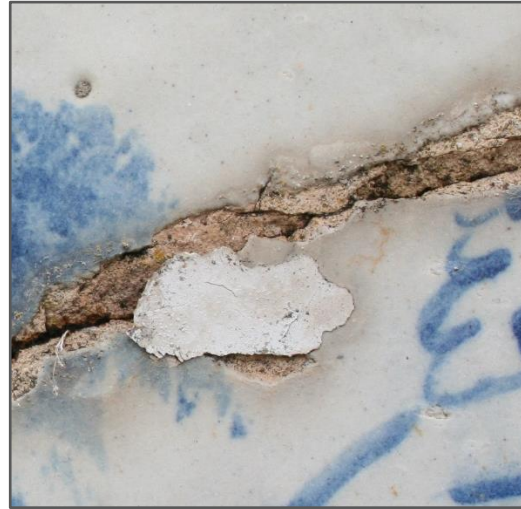
Figura 90. Pasta de preenchimento fissurada. Palácio Nacional de Queluz, Canal dos Azulejos, 2014.
