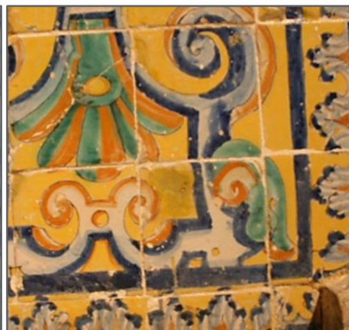
Figura 64. Os materiais de preenchimento encontram-se bem nivelados mas com alteração cromática das reintegrações. Parede lateral esquerda do nártex (Capela de S. Roque), 2012.
