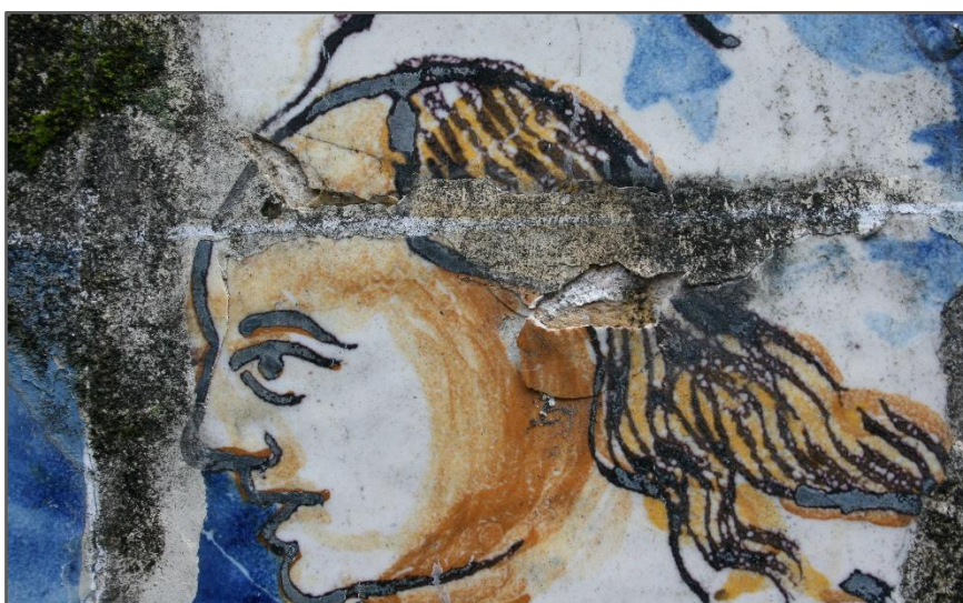
Figura 93. Destacamento de vidrado junto a uma área preenchida com pasta de preenchimento que se encontra também em destacamento. É visível a presença de microorganismos tanto sobre os vidrados como sobre as pastas de preenchimento. Palácio Marqueses de Fronteira, 2014.
