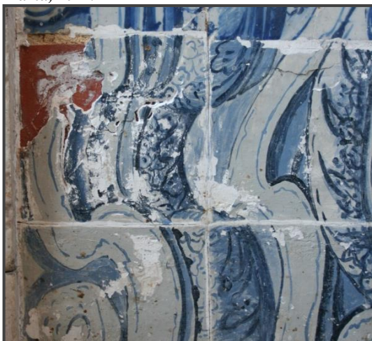
Figura 72. Material de preenchimento em avançado estado de degradação, com zonas em destacamento. Convento de Santo António dos Capuchos, 2012.
