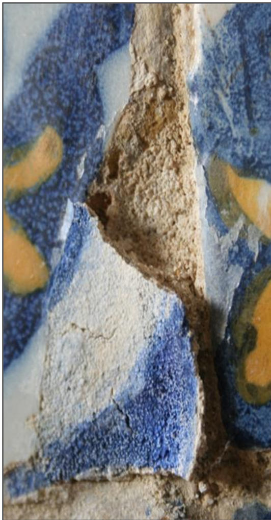
Figura 70. Material de preenchimento de lacunas em destacamento. Claustro inferior Igreja e Convento de Santa Marta/ Hospital de Santa Marta, 2012.
