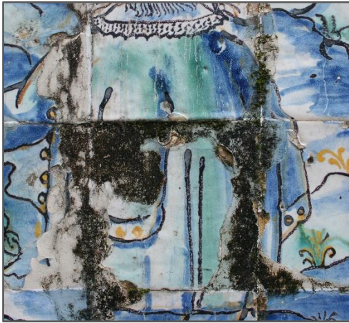
Figura 74. Material de preenchimento contaminado por microorganismos. Palácio Marqueses de Fronteira, 2014.
