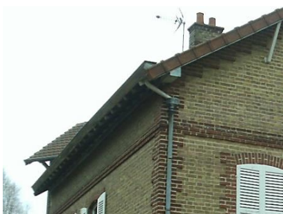
Photo 25 : Système de canalisation pour collecter les eaux pluviales. Source : Auteur.
