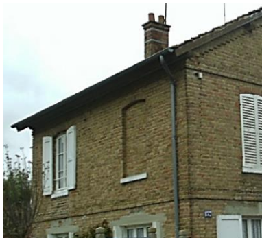
Photo 17 : Système de canalisation pour collecter les eaux pluviales. (2013). Source :
