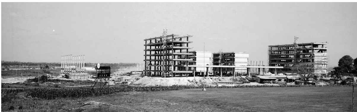
Photo 46 : Vue générale de la CUJAE en construction —avril, 1962—. De gauche à droite : Facultad de Eléctrica , Salles de clase Ingeniería Industrial , Salles de clase Ingeniería Química , Facultad de Industrial et Facultad de Arquitectura . Source : Contribution du Lic. Juan de Las Cuevas Toraya.
