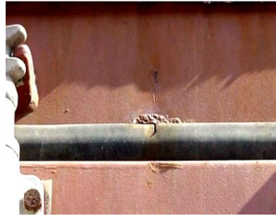
Figura 25 – Este tipo de dano é mais do que uma simples corrosão, o corte na junta com a corrosão significa que o contentor bateu em algum local. A solução aqui é reparar a corrosão e substituir a junta. (GREENCUBE, 2012)
