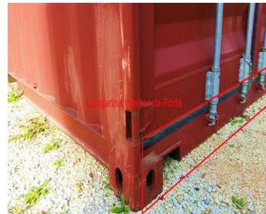
Figura 65 - Viga longarina na zona da porta que nunca se deve cortar. (IKEGAMI, CASTILHO, & KOCHANOWSKI, 2015)
