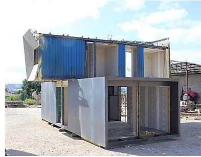
Figura 202 – Piso térreo da habitação já com revestimento interior e exterior. (Domux Box)
