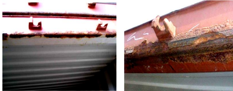
Figura 20 e 21 – Vários tipos de corrosão que podem ser reparáveis. (GREENCUBE, 2012)
