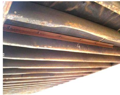
Figura 38 - Nesta imagem podemos ver uma tentativa de reparação das vigas longarinas, contudo este tipo de reparação não é uma boa solução. (GREENCUBE, 2012)
