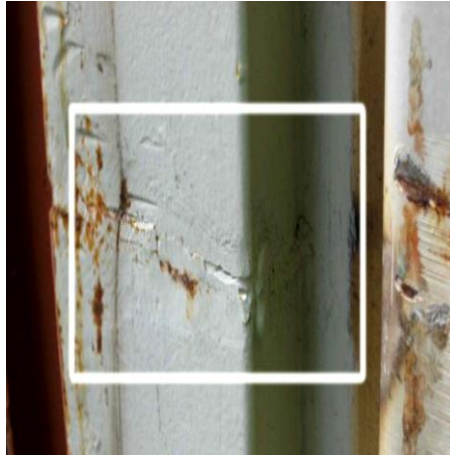
Figura 36 – A viga de canto do contentor, foi cortada e depois reparada, é um problema grave, porque quando se corta uma viga que é estrutural, pode comprometer toda a estrutura do contentor. (GREENCUBE, 2012)
