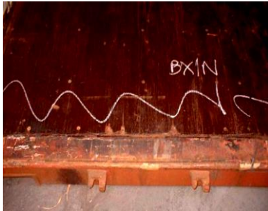
Figura 33 – o dano mais comum no piso, localiza-se na zona da entrada do contentor, devido à carga e descarga constante de material. (GREENCUBE, 2012)
