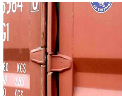
Figura 27 – Juntas dobradas ou deformadas, pode tornar-se um problema, e muitas vezes pior do que a corrosão. (GREENCUBE, 2012)
