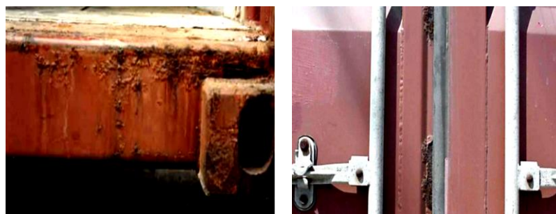
Figura 22 e 23 – Corrosão reparável, quando raspada, lixada e pintada. (GREENCUBE, 2012)
