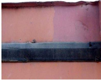
Figura 24 – Junta do topo do contentor marítimo danificada, a solução passa por, quando possível, substituir a junta. (GREENCUBE, 2012)
