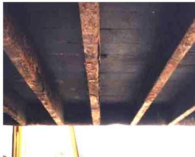
Figura 37 - Vigas longarinas da base do contentor onde assenta o pavimento, nesta imagem vimos muita corrosão nessas vigas, contudo muitas vezes basta lixar essa corrosão, desde que não interfira na estabilidade do contentor, até porque a corrosão não enfraquece o aço, a menos que seja grave. O que é recomendado é uma lavagem com jato de alta pressão, para remover qualquer resíduo. (GREENCUBE, 2012)
