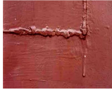
Figura 31 – É importante perceber que uma soldadura nunca deve exceder os 200mm de comprimentos. Quando estas dimensões são ultrapassadas podem por em risco a estrutura do contentor (sentido longitudinal). (GREENCUBE, 2012)
