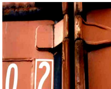
Figura 26 – Dobradiça em muito mau estado, deve ser substituída. (GREENCUBE, 2012)
