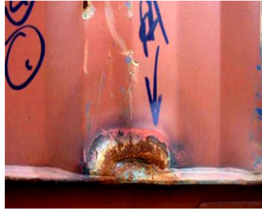
Figura 30 – Este tipo de patologia deve ser endireitado antes de se soldar. (GREENCUBE, 2012)
