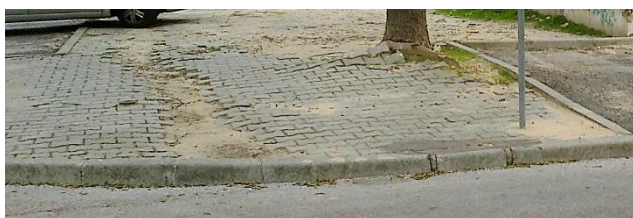
Figura 21- Degradação do pavimento em betão, (Fonte: autora do trabalho)
