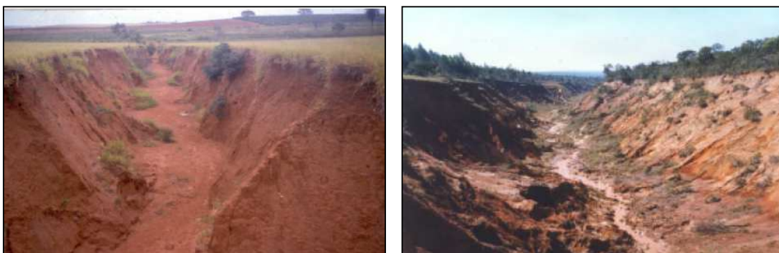
Figura 1.5 – a) Erosão em sulcos com desmoronamento de massa de solo; b) Erosão por desabamento (em voçorocas ) (Almeida Filho et al. 2001).
