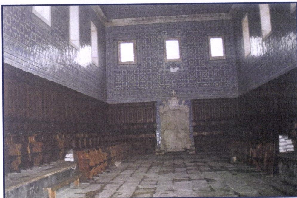
Foto 63 – Humidade ascendente no pavimento do coro das monjas.
