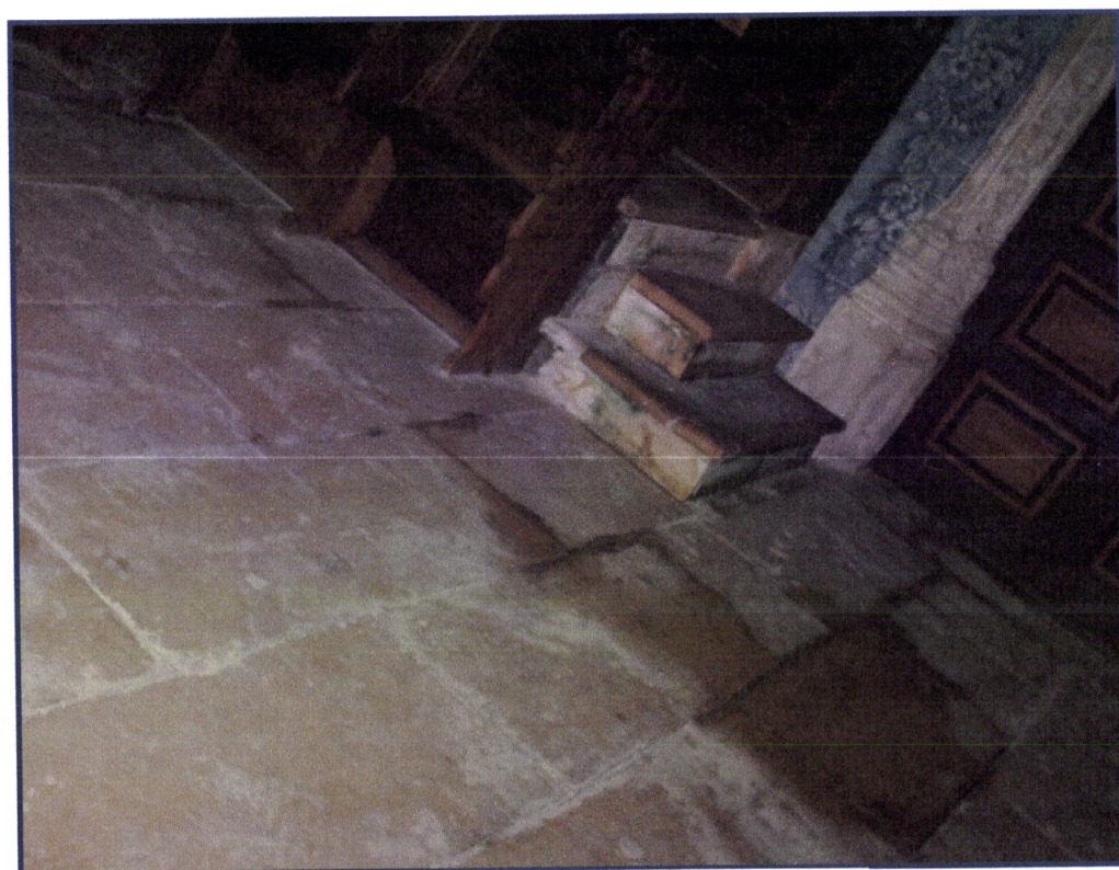
Foto 64 – Mancha de humidade junto ao portal manuelino
