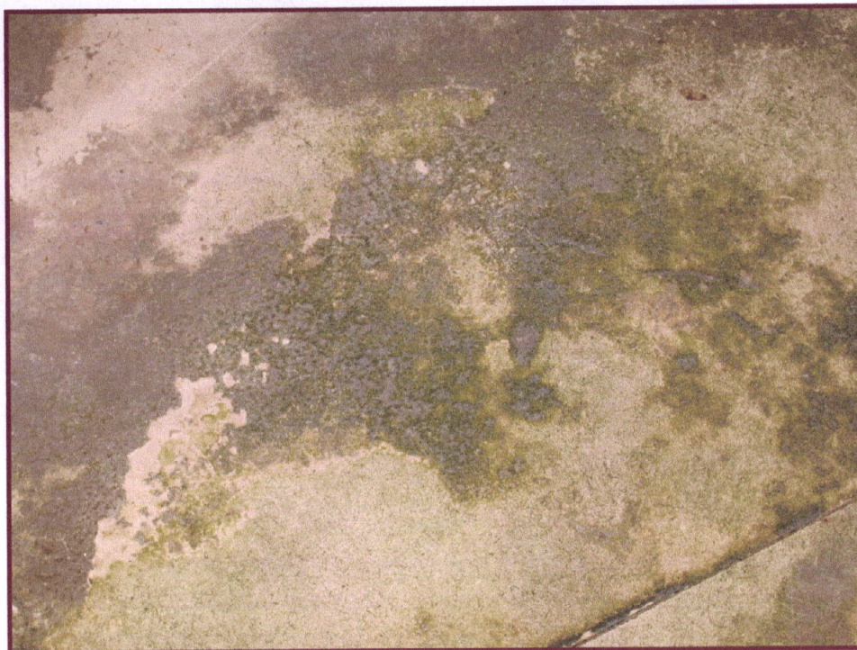
Foto 67 – Mancha de humidade no pavimento da ante-sacristia.
