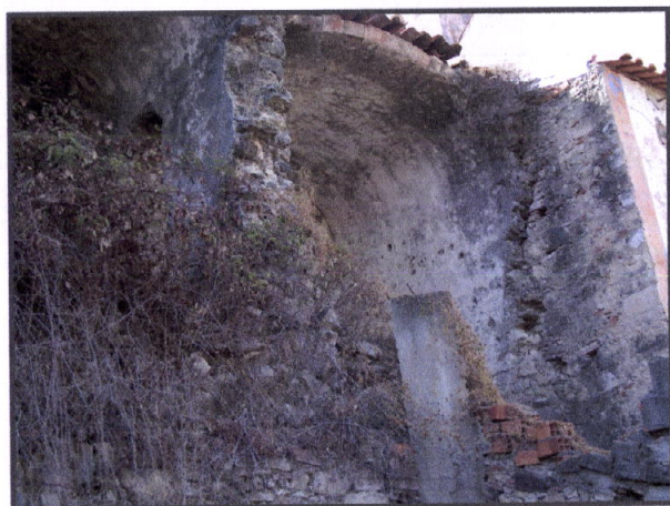
Foto 87 – Alçado nascente do dormitório: desagregação da alvenaria.
