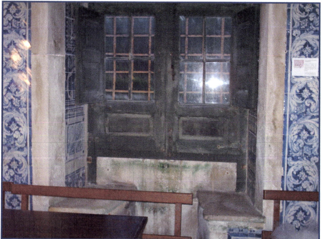
Foto 66 – Humidade por infiltração. Parede norte da sacristia.
