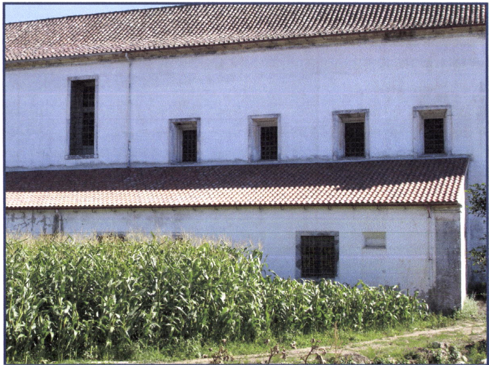
Foto 70 – Alçado norte da sacristia para o qual é projectada a água do sistema de rega do terreno contíguo.
