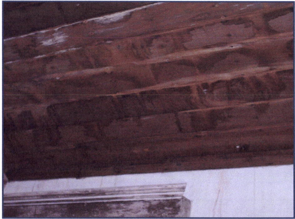
Foto 69 – Tecto da ante-sacristia: sinais de humidade por infiltração.
