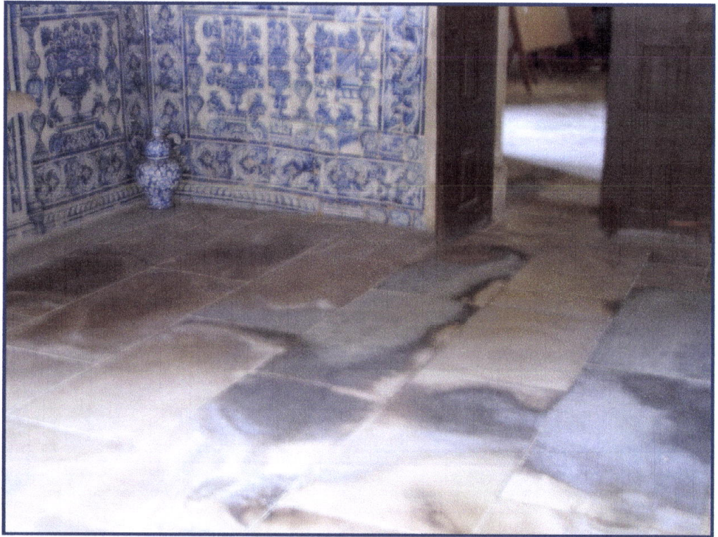
Foto 65 – Mancha de humidade no pavimento da sacristia.
