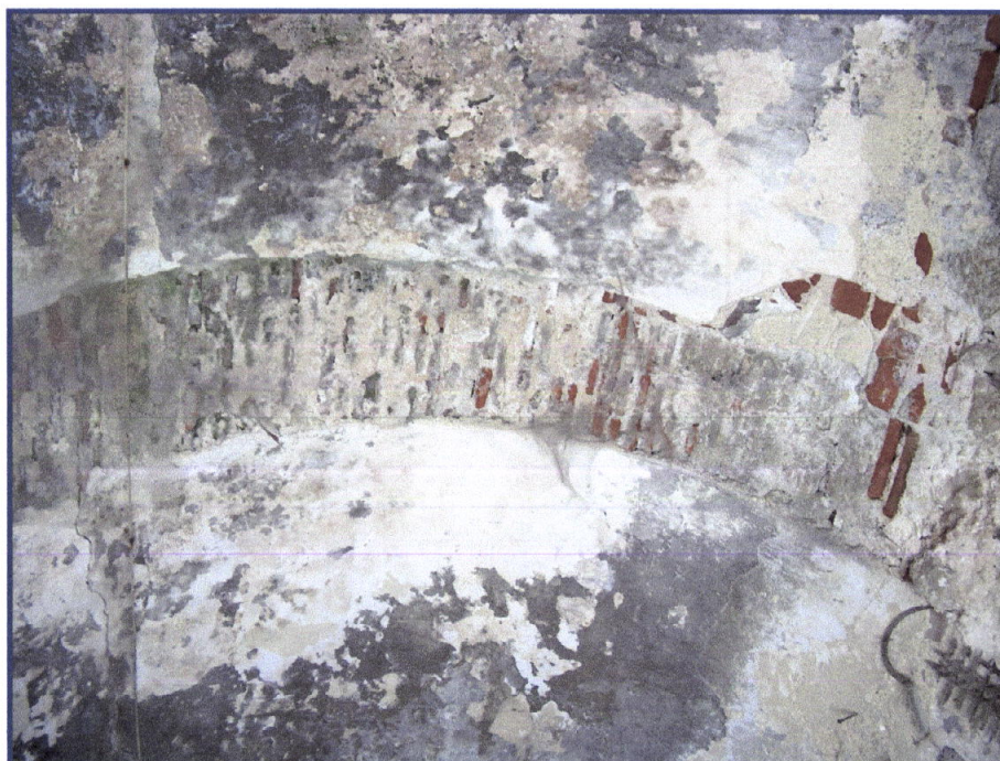
Foto 94 – Manchas de humidade na abóbada do piso térreo do dormitório.
