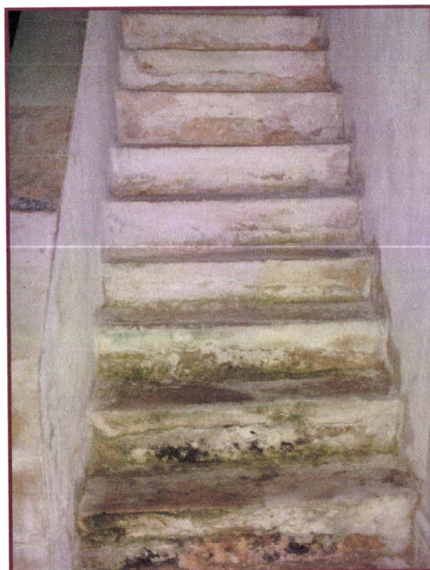
Foto 68 – Ante sacristia: manchas de humidade na escada de acesso ao púlpito.
