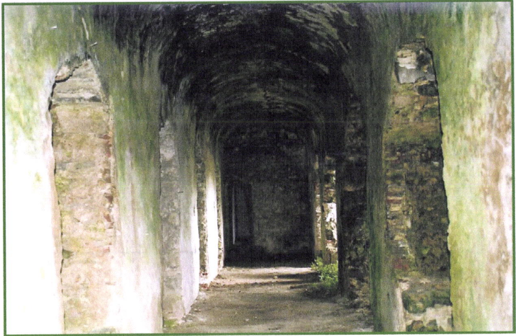
Foto 97 – Corredor do dormitório das monjas: colonização biológica.
