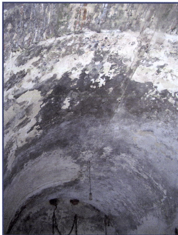
Foto 95 – Manchas de humidade e colonização líquénica. Piso térreo do dormitório.
