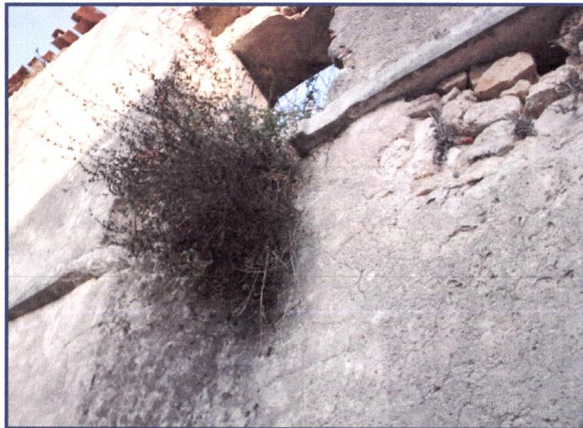
Foto 44 – Faixa de cantaria com a função de impedir a escorrência de águas pluviais ao longo da parede. Alçado poente do dormitório.
