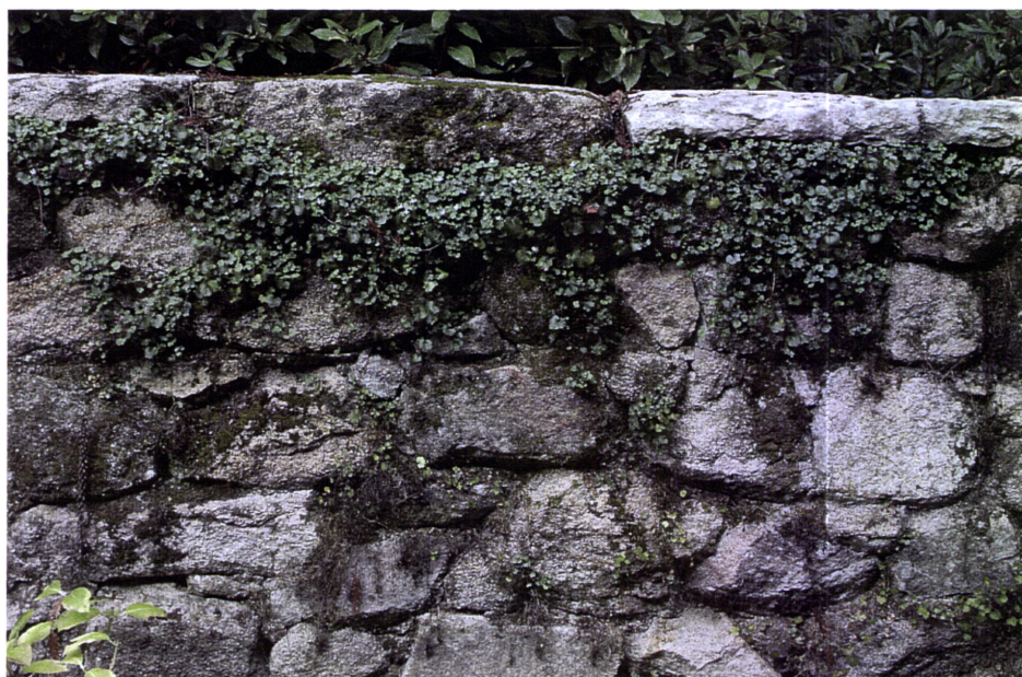
Figura 67 – Muro de suporte com alvenaria de pedra à vista e infestado de plantas superiores
