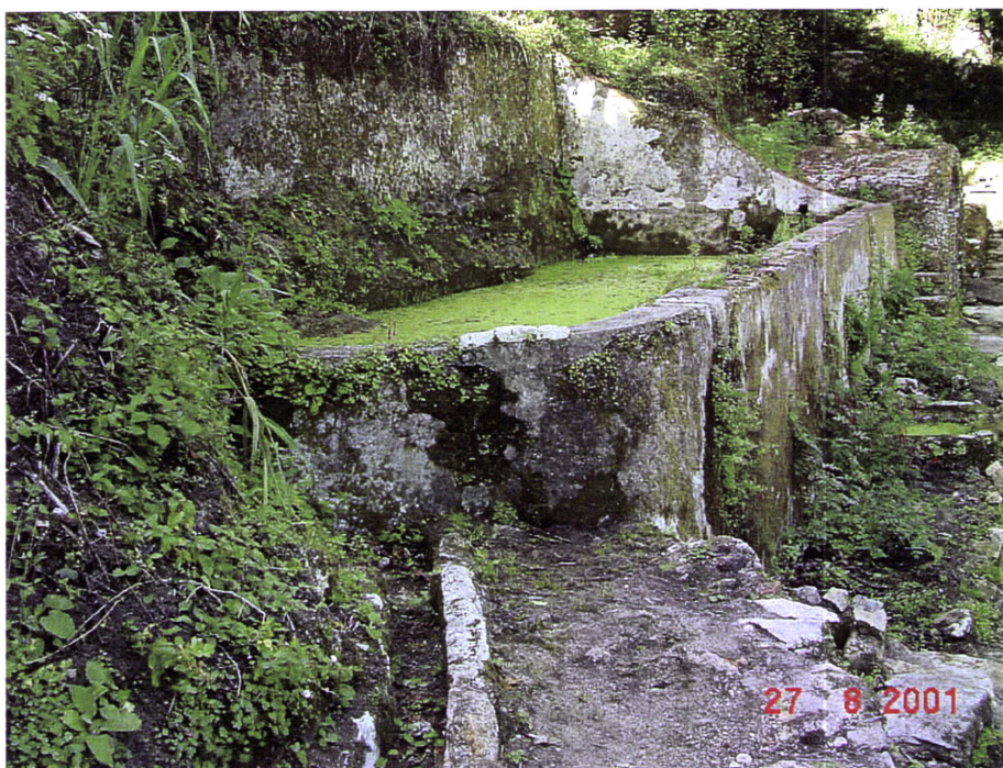
Figura 63 – Tanque 3 com saída de água à cota 316,00 m por regadeira
