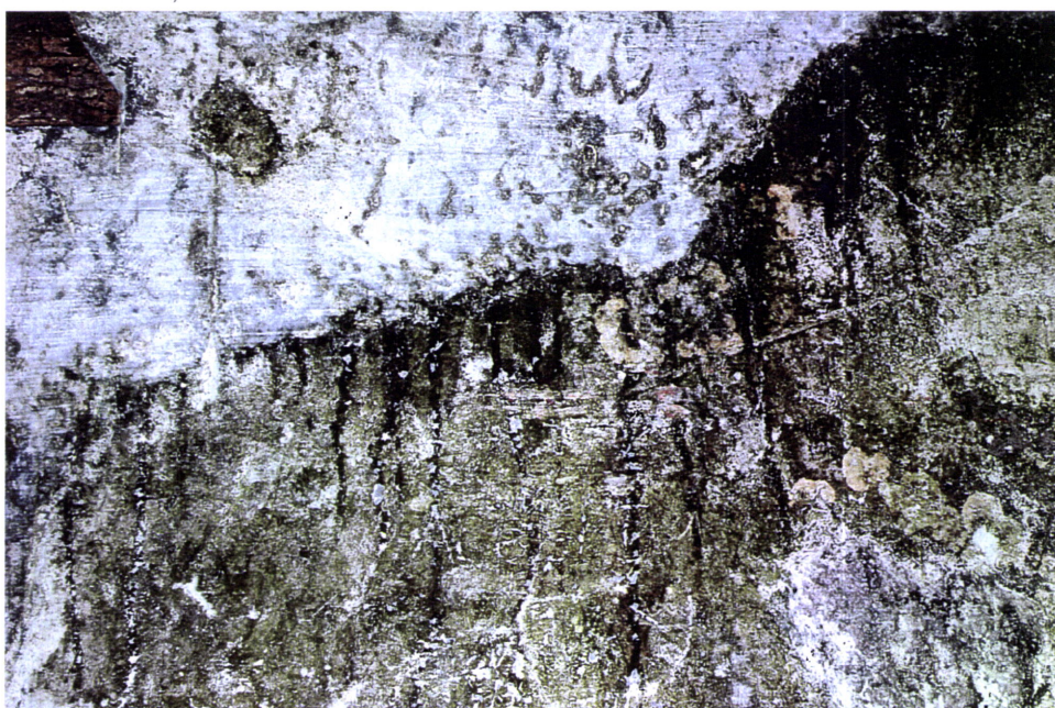
Figura 40 – Alteração do granito nas paredes
