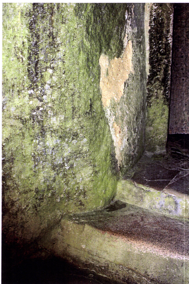
Figura 41 – Estado das paredes no interior do convento por humidade
