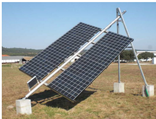
Figura 13: Seguidor instalado no parque PETER.
