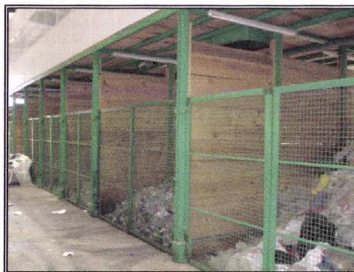
Fotografia 5.4 – Locais de deposição (“boxes”) do material triado na mesa de triagem, caindo por acção da gravidade da mesa de triagem situada no piso superior.
