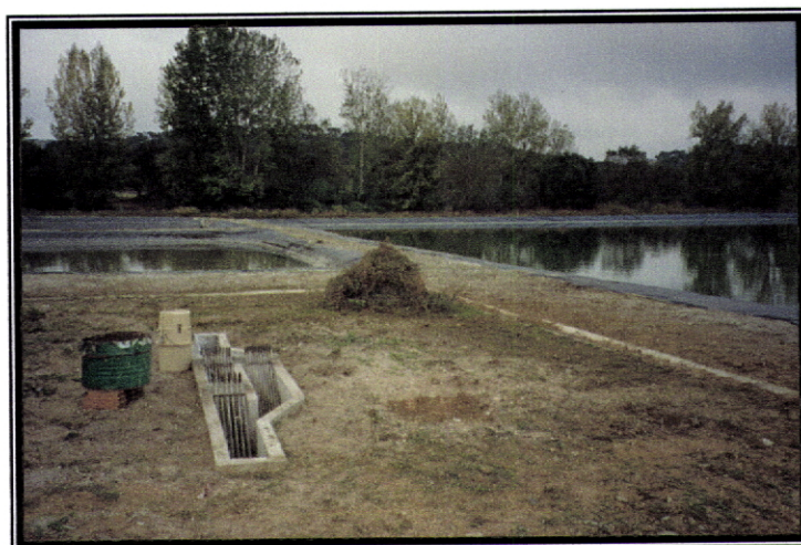
Figura 2.3 - ETAR de Arraiolos. Perspectiva da entrada e do amostrador automático de amostras compostas em 02.11.98
