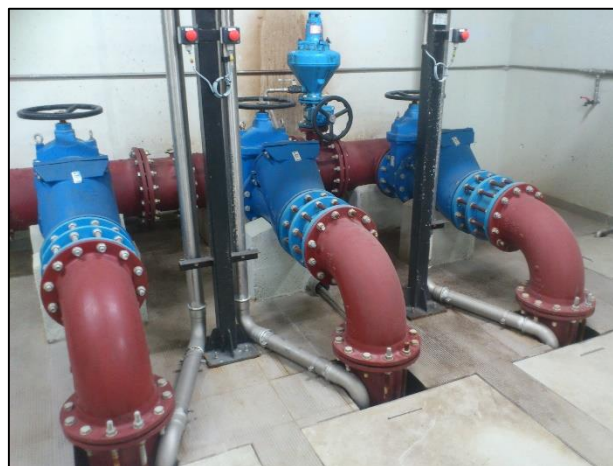
Figura 3.8 – Grupos eletrobomba da estação elevatória de Avieiros.
