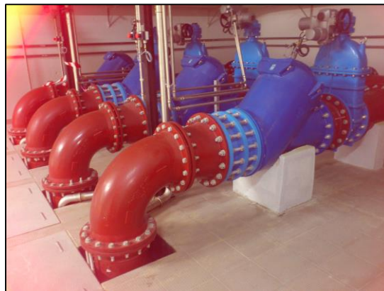
Figura 3.18 – Grupos eletrobomba da estação elevatória de Icesa.
