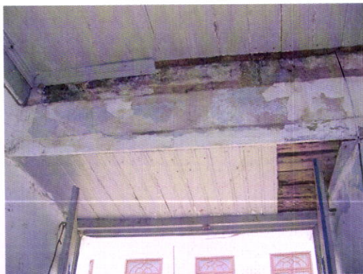
Fig. 54- Alcântara. Exemplo de infiltrações em tecto
