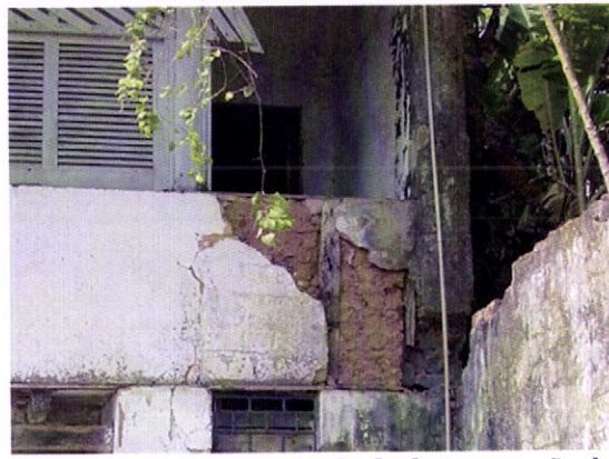
Fig. 53- Alcântara. Exemplo de desagregação de revestimentos.
