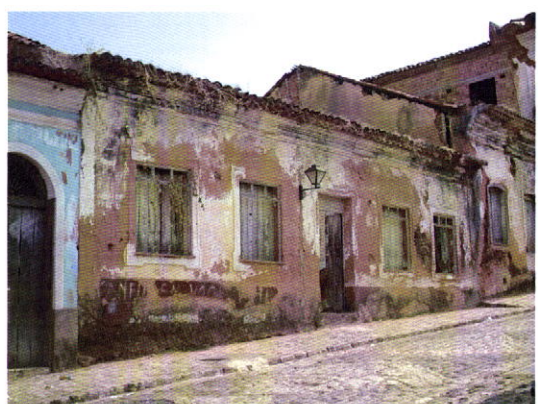
Fig. 84 - Alcântara. Ladeira do Jacaré. Imóvel nº 59, em ruína.
