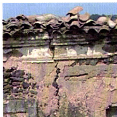
Fig. 49- Alcântara. Fendilhação num imóvel da ladeira do Jacaré.
