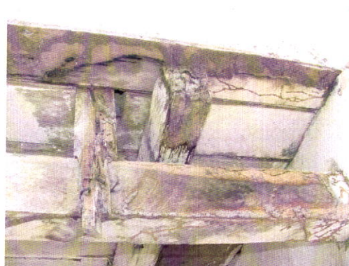
Fig. 57- Alcântara. Exemplos de infiltração nas vigas.
