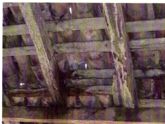
Fig. 59- Alcântara. Exemplo de anomalias em cobertura.
