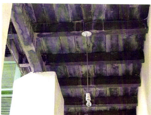
Fig. 56- Alcântara. Exemplos de infiltrações em barrote.
