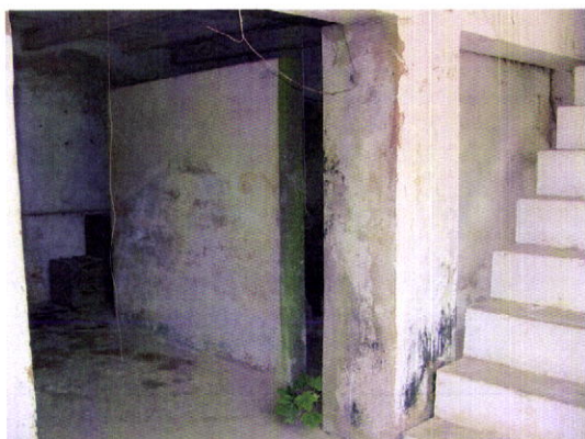
Fig. 48- Alcântara. Acesso da humidade pelo solo.
