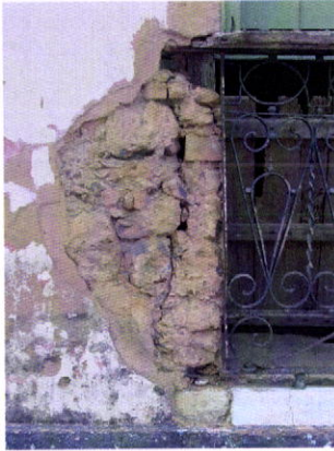
Fig. 52- Alcântara. Exemplo de desagregação de revestimentos.
