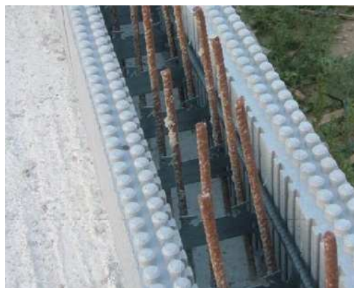
Fig. I.4 – Ferro de arranque para a ligação entre laje de fundação e parede (ARGISOL, 2010).
