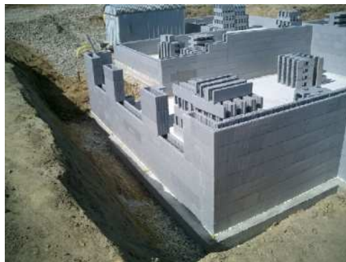
Fig. I.70 – Parede exterior duma cave, com metade da parede abaixo do nível do terreno (ARGISOL, 2010).
