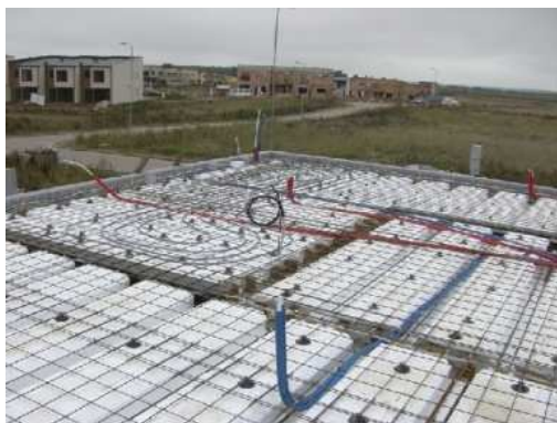
Fig. 4.5 – Cofragem de laje com cofragem em EPS reforçado interiormente por barras de aço, 2 (ARGISOL, 2010).
