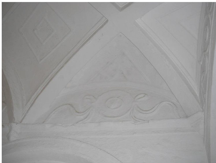
Fig. 40 Pormenor da abóbada do lanço Norte do Claustro. Fonte: elaboração própria (Novembro de 2013)
