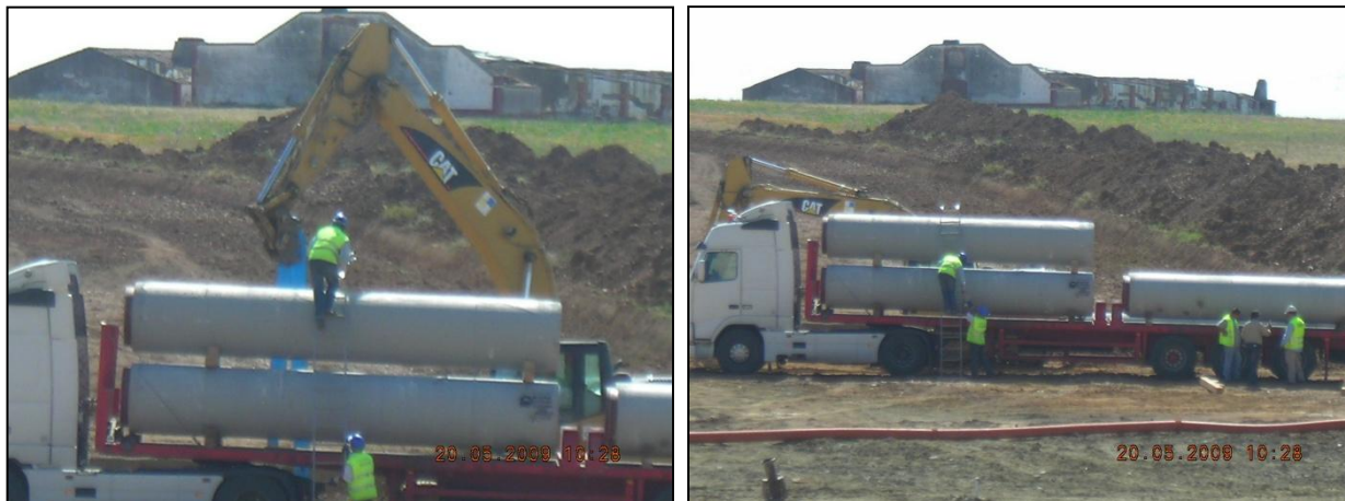
Figura. 18 e 19 – Não Conformidade – Risco de queda em altura
