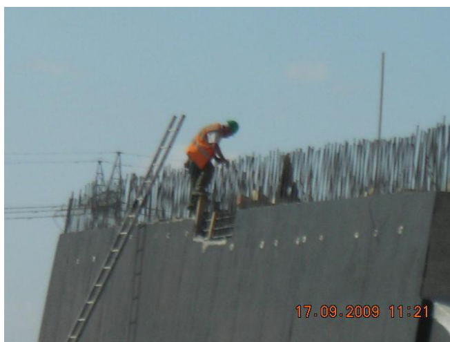
Figura. 23 – Não Conformidade – Risco de queda em altura
