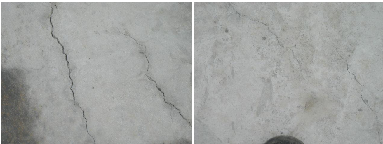
Figuras 16 e 17 – Fissuração do betão
