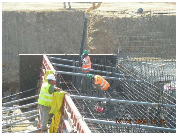
Figura. 20 – Não Conformidade – Risco de queda em altura
