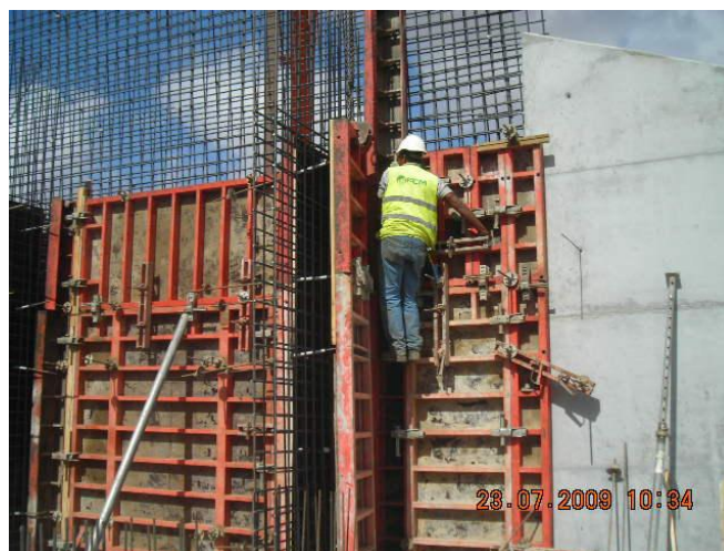
Figura. 22 – Não Conformidade – Risco de queda em altura
