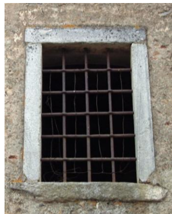
Ilustração 56 - Montemor-o-Novo. Antiga igreja de São Tiago. Gradeamento em ferro na janela da cabeceira - (situação anterior à intervenção).
