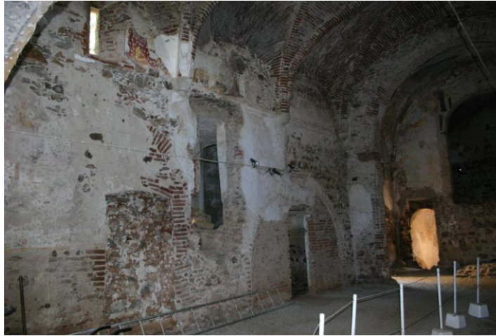
Ilustração 40 - Montemor-o-Novo. Antiga igreja de São Tiago. Porta entaipada no alçado norte – Vista interior (situação anterior à intervenção).
