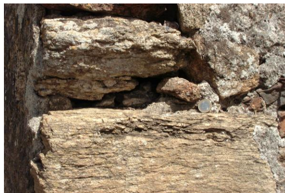
Ilustração 53 - Montemor-o-Novo. Antiga igreja de São Tiago. Separação em placas (situação anterior à intervenção).
