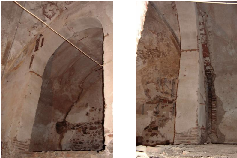
Ilustração 58 - Montemor-o-Novo. Antiga igreja de São Tiago. Problemas estruturais no altar-mor (situação anterior à intervenção).
