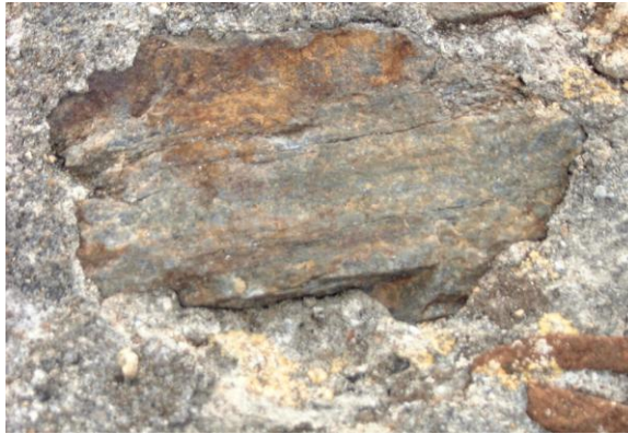
Ilustração 52 - Montemor-o-Novo. Antiga igreja de São Tiago. Fissuração (situação anterior à intervenção).
