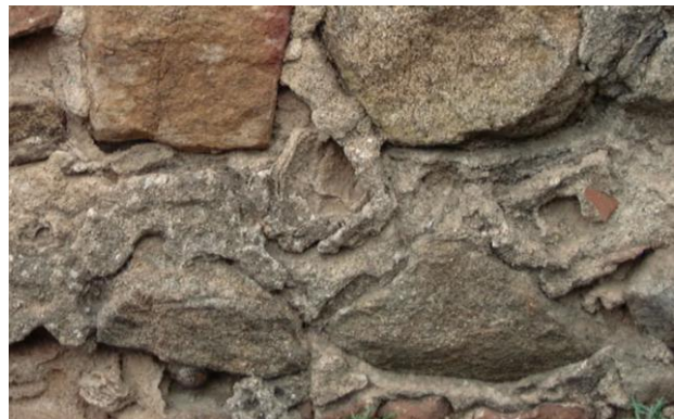
Ilustração 48 - Montemor-o-Novo. Antiga igreja de São Tiago. Formação de alvéolos na argamassa do reboco - (situação anterior à intervenção).
