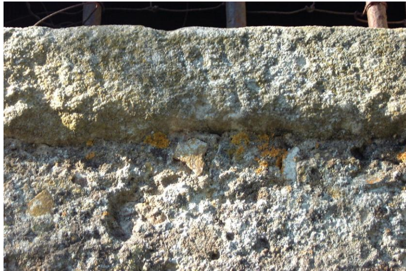
Ilustração 51 - Montemor-o-Novo. Antiga igreja de São Tiago. Pormenor do parapeito da janela da capela-mor - (situação anterior à intervenção).
