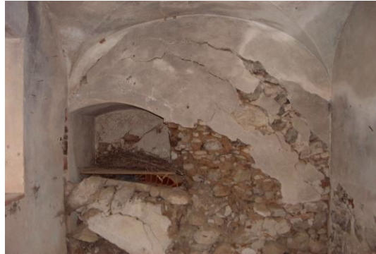
Ilustração 59 - Montemor-o-Novo. Antiga igreja de São Tiago. Problemas estruturais na zona do ossuário - (situação anterior à intervenção).
