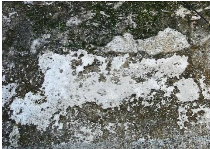
Ilustração 54 - Montemor-o-Novo. Antiga igreja de São Tiago. Eflorescência salina (situação anterior à intervenção).
