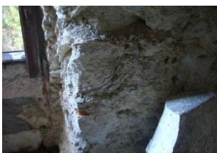
Fig. 76 - Deterioração de pedra em alvenarias
