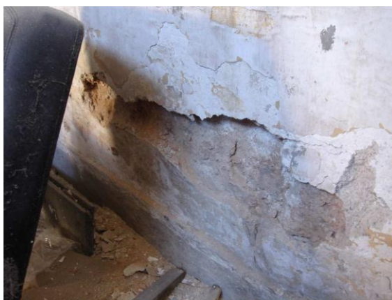
Fig. 75 - Patologias dos rebocos interiores subsistentes
