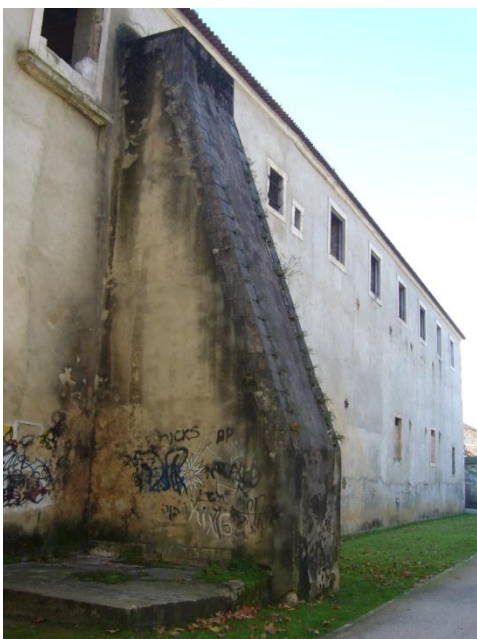
Fig. 23 - Alçado Norte – contraforte com cunhais formados por calcário aparelhado. As manchas escuras indiciamos escorrimentos de águas da chuva.
