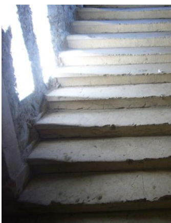
Fig. 48- Escadas com acentuado desgaste dos degraus
