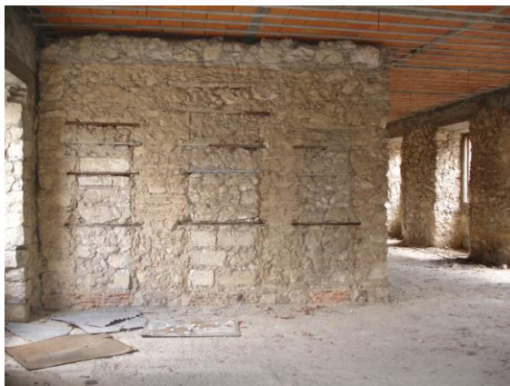
Fig. 53 - Parede estrutural junto às escadas da ala poente do dormitório, com deslocamento relativamente à parede exterior.
