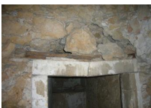
Fig. 77 - Fracturação de verga em cantaria de calcário
