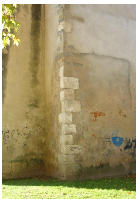
Fig. 24 - Alçado Norte – contraforte com cunhais formados por calcário aparelhado. As manchas escuras indiciamos escorrimentos de águas da chuva.
