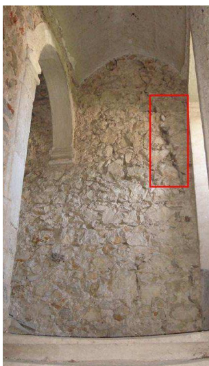
Fig. 78 - Fendilhação em paredes exteriores
