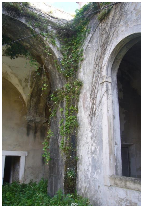
Fig. 37- Colonização biológica devido ao colapso do sistema de recolha de águas do terraço.
