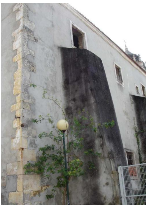
Fig. 21 - Cunhal dos alçados poente e norte com aparelho de pedra de irregular. As manchas escuras indicam a existência de escorrimentos
