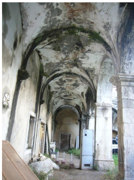
Fig. 33 - Tectos das galerias com manchas negras devido à infiltração da água da chuva.
