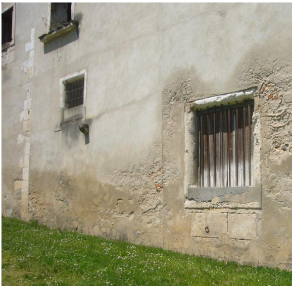
Fig. 26 - Vista parcial do alçado Nascente – degradação dos rebocos cimentícios provocada por humidade ascensional e envolvente dos vãos. Decaimento da pedra de cantaria por acção da água e agentes atmosféricos
