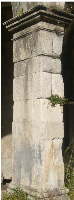
Fig. 30 – Coluna do claustro exemplo de degradação dos materiais pétreos
