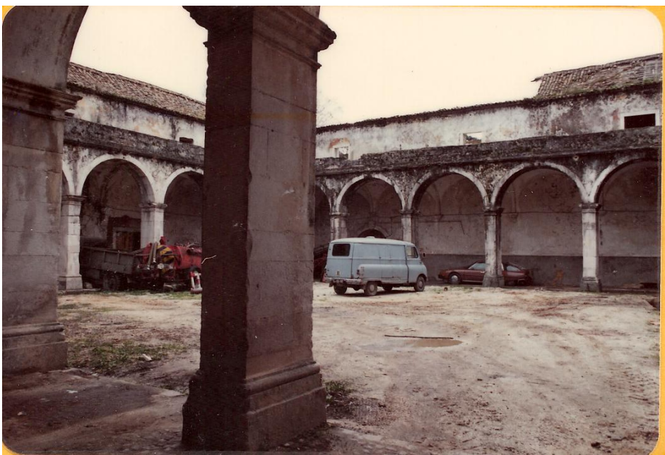
Fig. 10 - Galerias do claustro. É visível o estado de ruína da cobertura.
