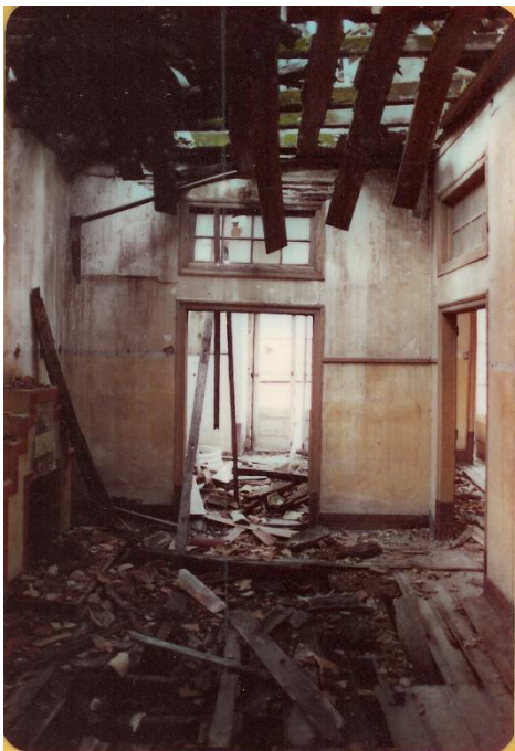
Fig. 12 - Vista do interior de uma das alas mais degradadas do piso superior
