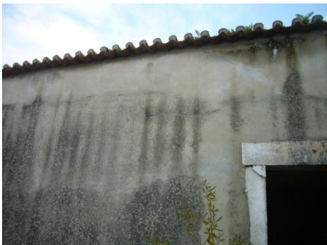
Fig. 72 - Escorrências em paredes
