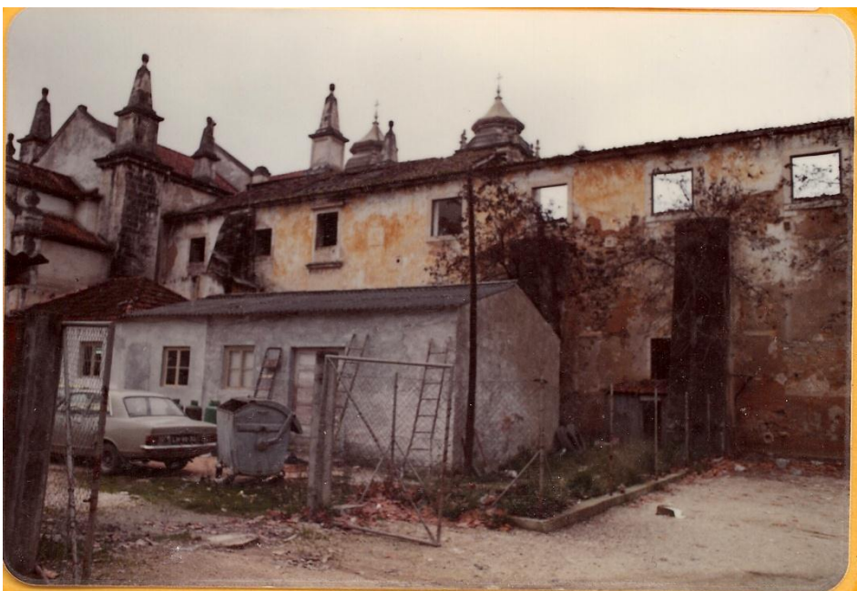
Fig. 8 - Alçado Nascente - é visível o estado de ruína de parte da cobertura
