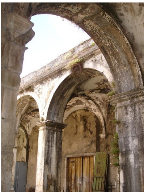
Fig. 32 - Situação de sujidades, pátina e patologia das pedras dos arcos e colunas do claustro.
