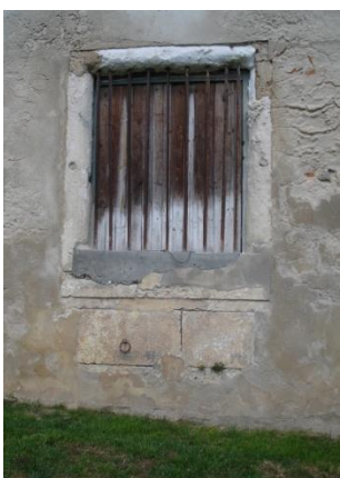
Fig. 74 - Degradação de rebocos e cantarias
