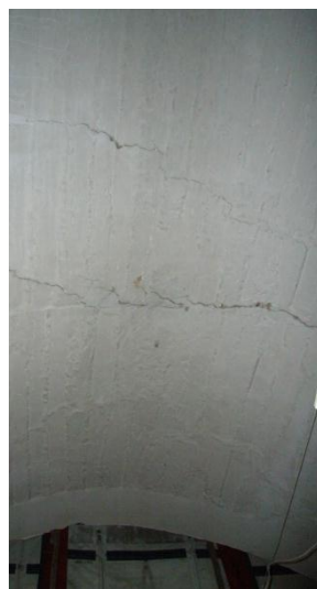
Fig. 79 - Fendilhação extensa na abobada de betão do armazem
