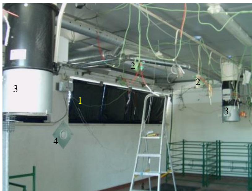
Figura 2 Interior sala da Sala de ambiente controlado (SAC) (1- Janelas,2-Sensores higrométricos, 3- Ventiladores 4- Ar condicionado).
