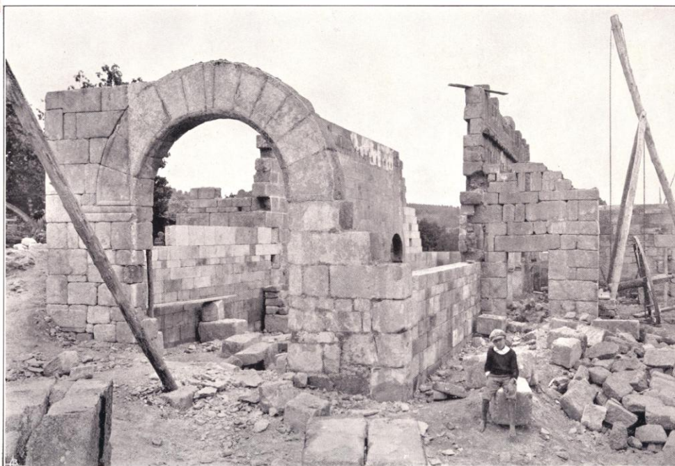
Est. 11 — Ângulo sudoeste do «nartex», em restauração, vendo-se o notável arco de cintro pleno, que lhe dá entrada, e parte da fachada principal correspondente à nave sul
