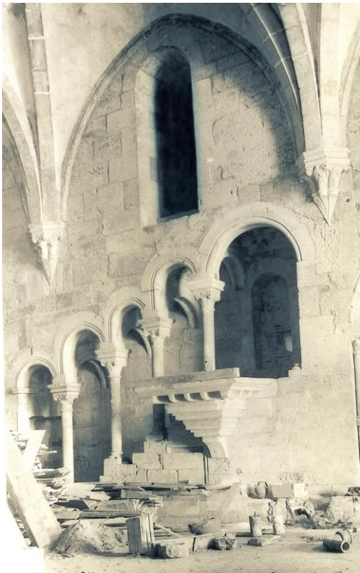
Fig. 249 – Mosteiro de Alcobaça. Refeitório dos Monges, depois da desmontagem do Teatro. Intervenção de reintegração, com restauro dos silhares. 1926-1928. Fotógrafo desconhecido. Mosteiro de Alcobaça. Coleção de Fotografias do Centro de Documentação do Mosteiro. Foto 0006. Vol. I, tomo 2, p. 1216.
