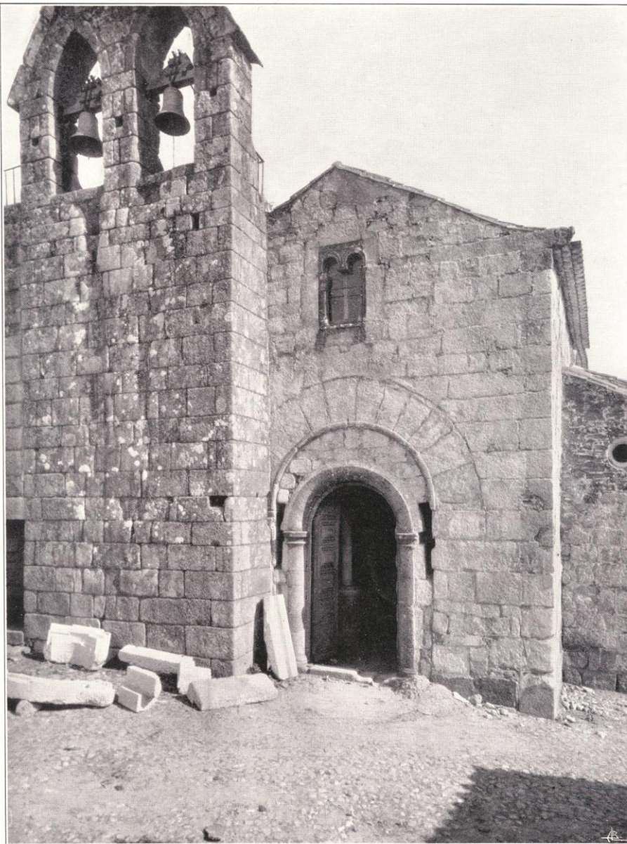
Est. 8— Fachada principal, sem as camadas de cal para facilitar o seu estudo
